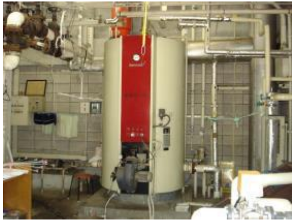
既存の灯油ボイラー
